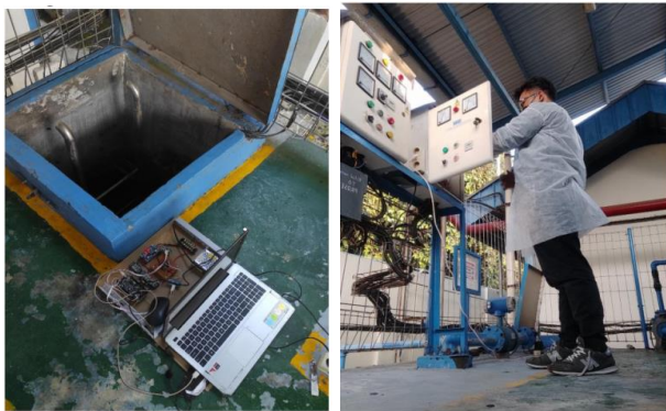
Gambar 7. Hasil Prototipe Perangkat Keras dan Dokumentasi Instalasi
