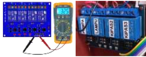
Gambar 32. Kondisi relay low
