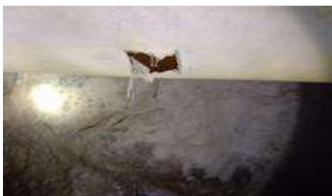
Gambar 1. Pada bagian Duct yang bocor
