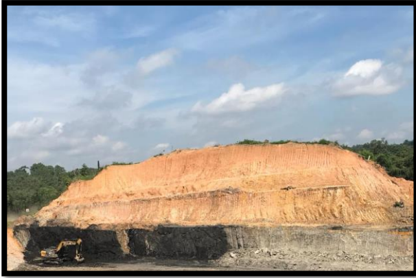
Gambar 1. Situasi Lereng Sebelum Terjadi Longsoran
