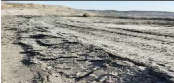
Gambar 1. Kondisi Jalan Aktual Pit Majapahit
