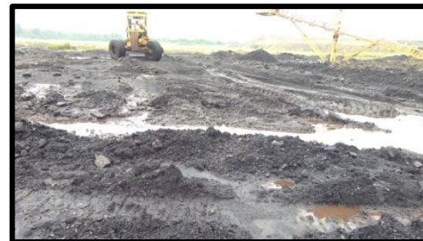
Gambar 7. Drainase yang kurang baik di Stockpile
