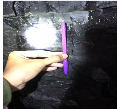
Gambar 3. Kekar pada Dinding Tunnel THC 04
