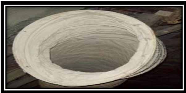
Gambar 12. Luas Pempang Duct
