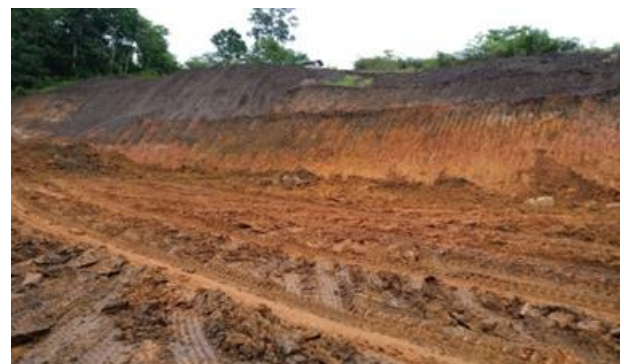
Gambar 1. Kondisi awal lereng [1]
