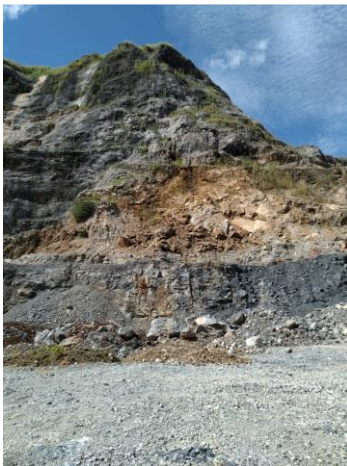
Gambar 1. Kondisi Lereng pada area existing Front II Section A-A'
