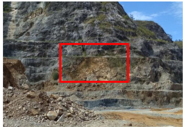
Gambar 5. Longsoran Pada Section A-A'
