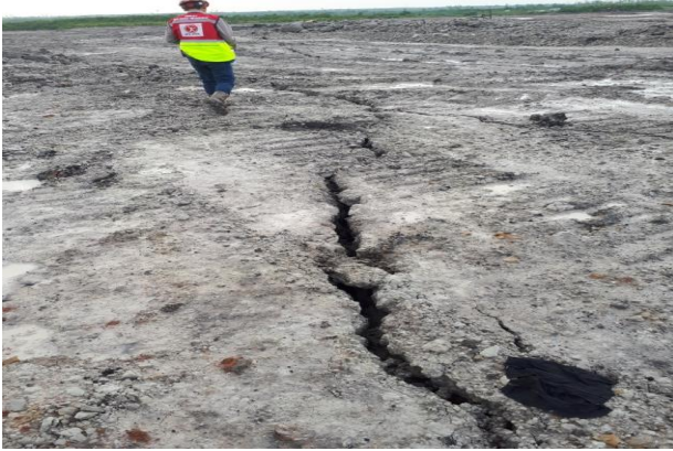
Gambar 4. Kondisi Jalan yang Rusak
