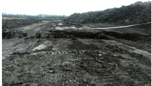
Gambar 3. Jalan di Area Disposal yang Amblas
