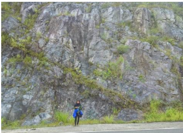
Gambar 1. Kondisi Front Lereng pada Lokasi Penelitian
