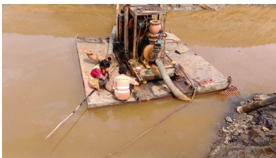
Gambar 5 Kondisi Aktual Pompa
