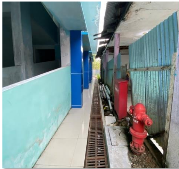
Gambar 1. Letak hydrant yang kurang tepat.
