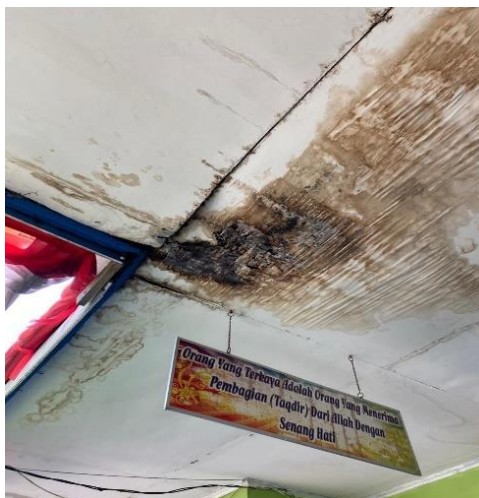
Gambar 2: Plafond Yang Rusak Akibat Kebocoran Atap
