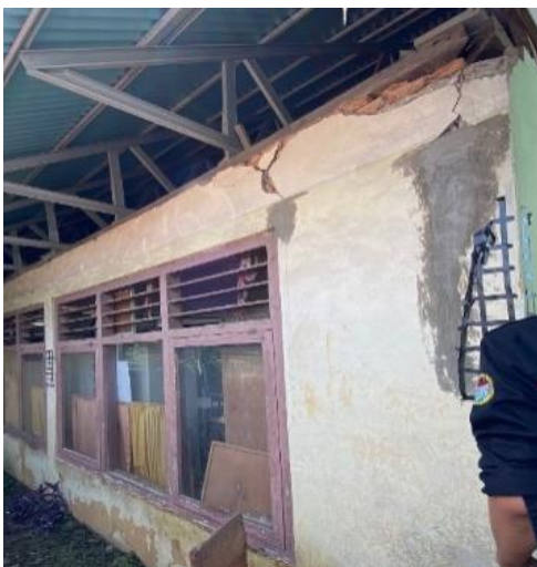
Gambar 4: Kolom Yang Tidak Terhubung Dengan Kerangka Atap
