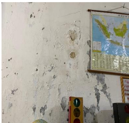
Gambar 6: Dinding Cat Yang Mulai Terkelupas
