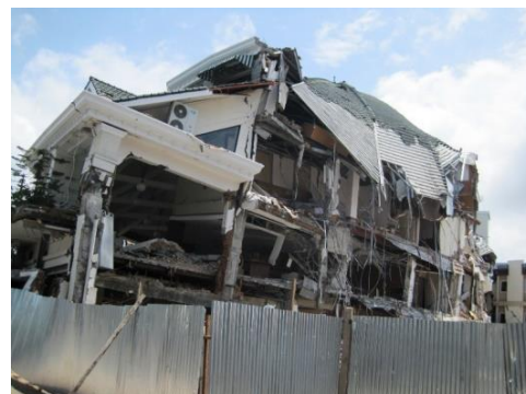
Gambar 4. Photo kerusakan bangunan akibat kejadian gempa 30 September 2000 berkekuatan 7.6Mw .
