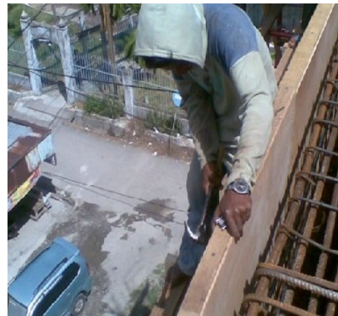
Pekerja di Lapangan tidak menggunakan APD
