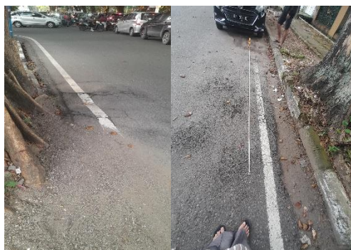
Gambar 9. Pohon yang Berdekatan dengan Infrastruktur Jalan Sekunder
