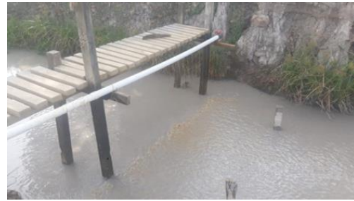
Gambar 7. Proses Injeksi Koagulan pada open chanel Inlet
